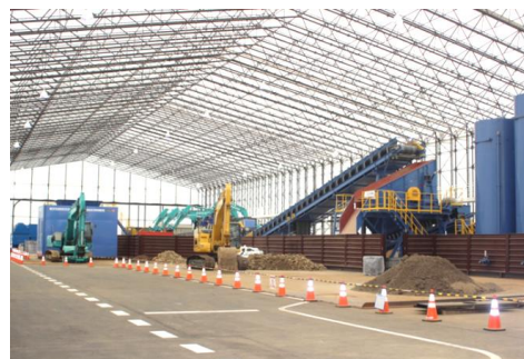
受入・分別施設（大熊工区）
